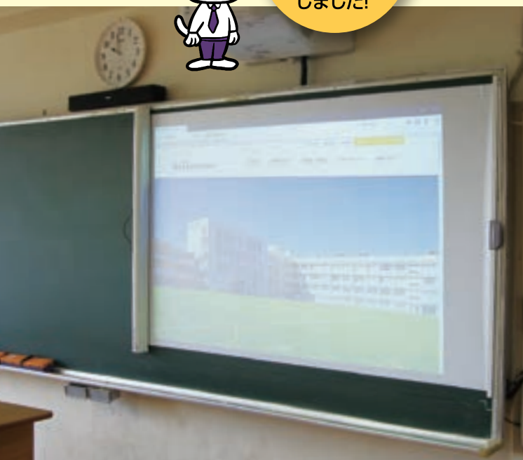
電子黒板 すべての教室に電子黒板が設置されインターネットも接続されました。
